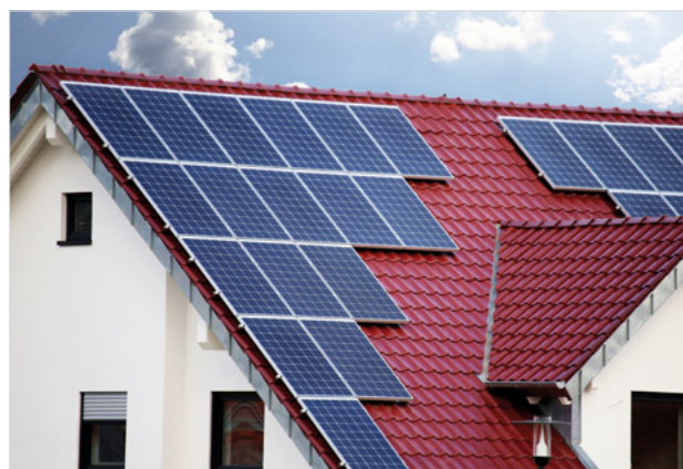
Zwykły dach + panele PV
